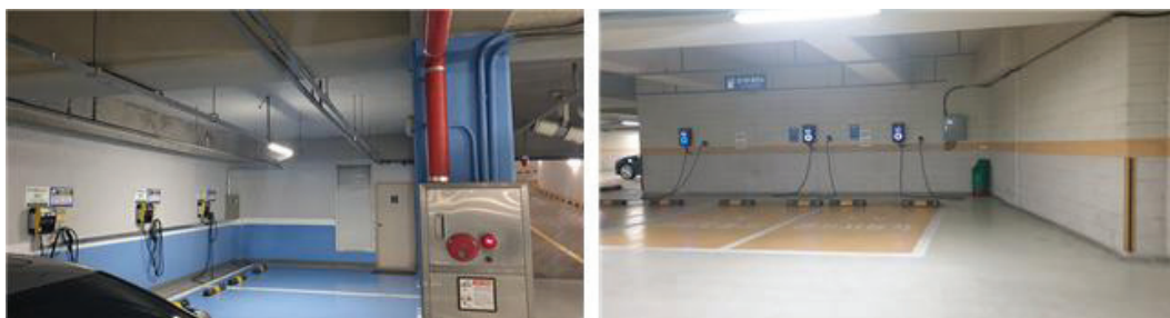
〈그림 35〉 화재감지기가 설치되지 않은 전기차 충전구역
