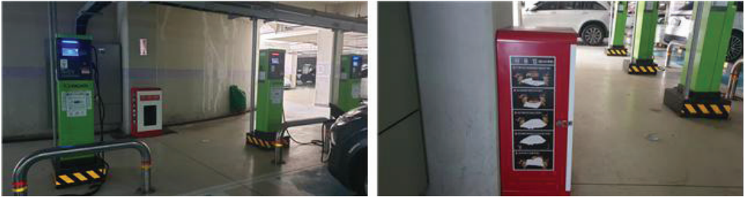
〈그림 37〉 충전구역 뒤편에 설치된 질식소화포 및 안전장구
