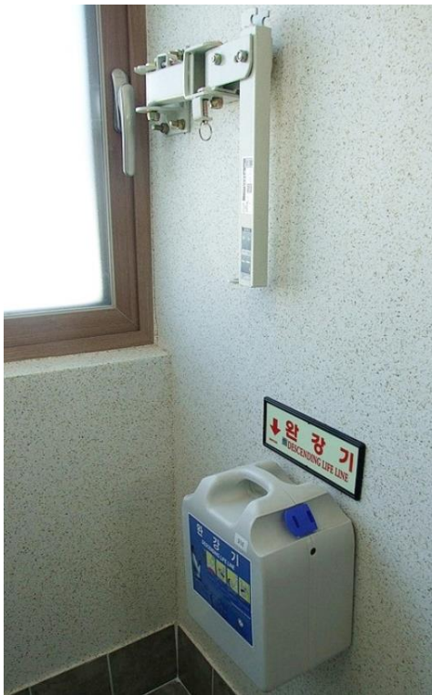
〈완강기 설치 상태〉
