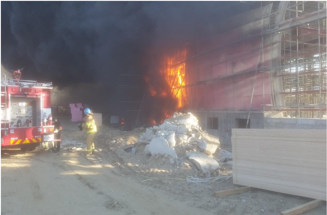
▲ 2017년 평창군 진부면 공사현장 화재
