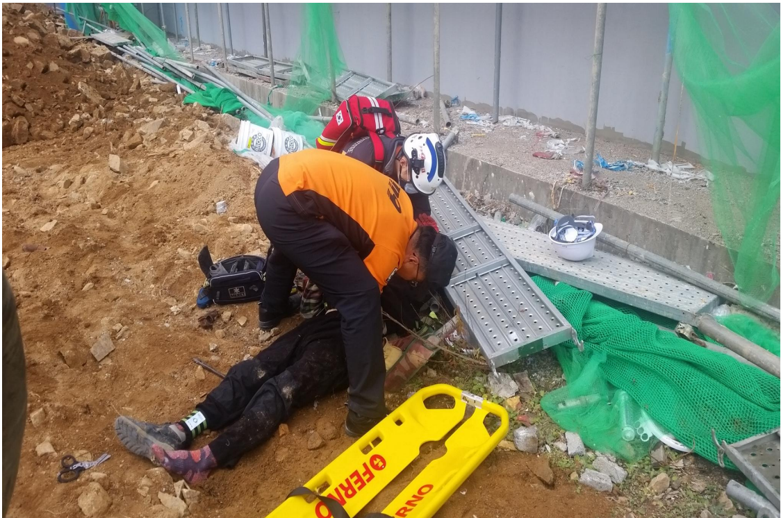
▲ 2017년 평창군 평창읍 공사현장 추락사고 구급활동
