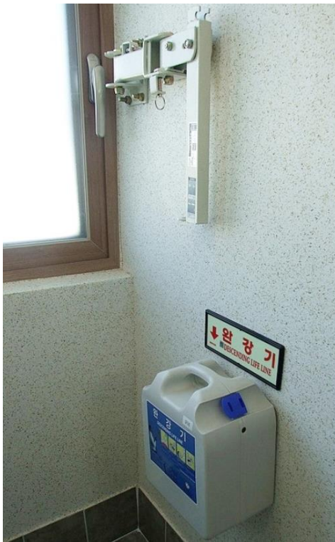
〈완강기 설치 상태〉
