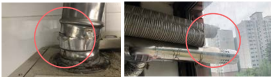
보일러 배기통 기밀불량 보일러 배기통 방조망 미설치, 이격 불량, 배기가스 역류 위험
