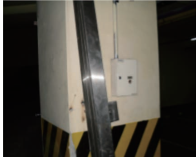
▲ 방화셔터 레일이 파손된 상태로 방치한 경우
