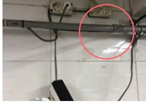
배관연결부와 전기 이격불량
