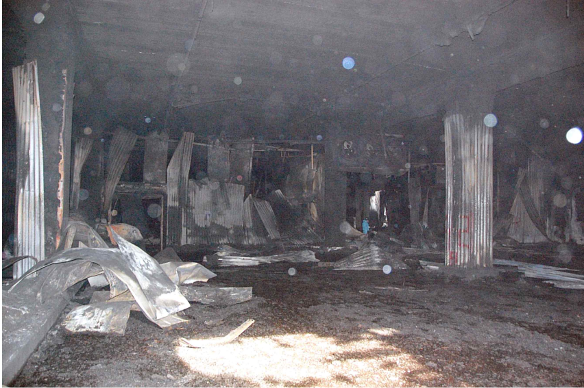
[ 그림 4-83 ] 13호실 내부의 소손상황(안쪽 → 출입문 방향 촬영)
