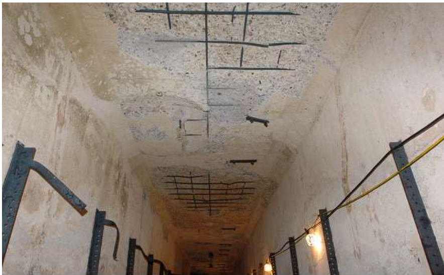
외관관찰 [ 그림 4-46 ] 폭열4 - 구리 지하전력구의 천장 폭열 모습.
