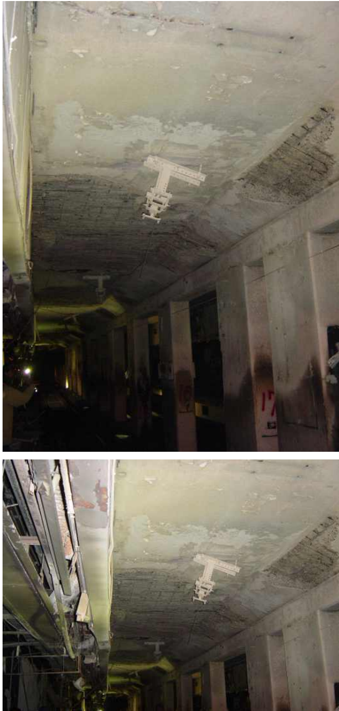
○ 대구지하철방화화재참사현장 - 중앙로역 선로 위 천장의 폭열 모습.
