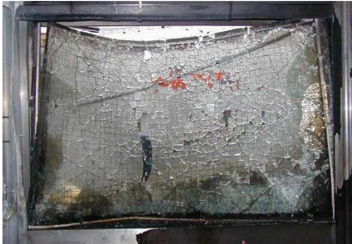
[ 그림 4-56 ] 망입유리의 열에 의한 파손
