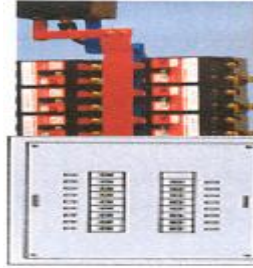
버스바 절연처리 코팅/열수축튜브 충전부 보호판 (아크릴판/금속제보호판)
