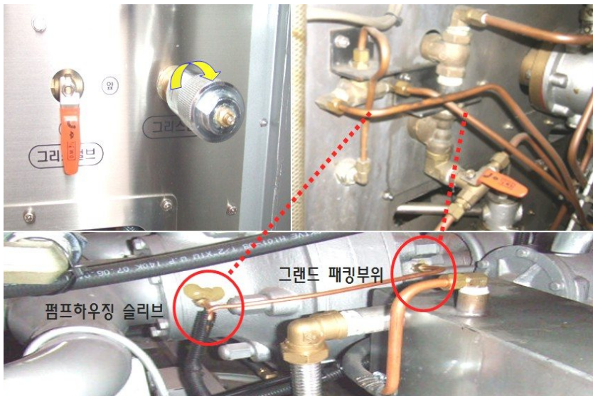
[그림 3-18] 펌프 윤활유 그리스 주입장치
