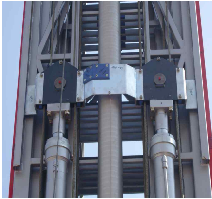
신장실린더 오일 누유 및 신장 롤러 확인
