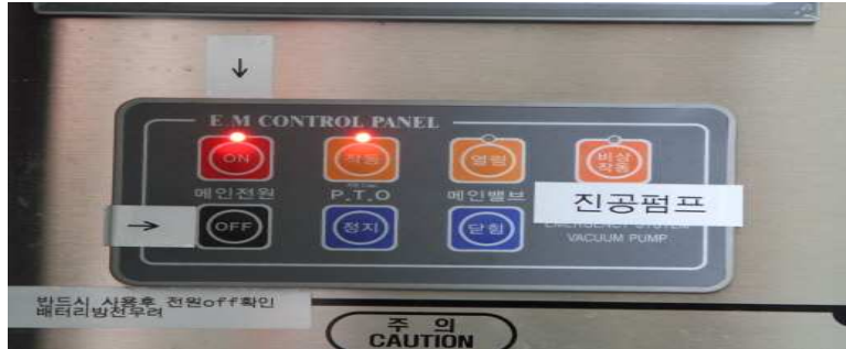
펌프조작반에 설치된 비상작동 조작스위치
