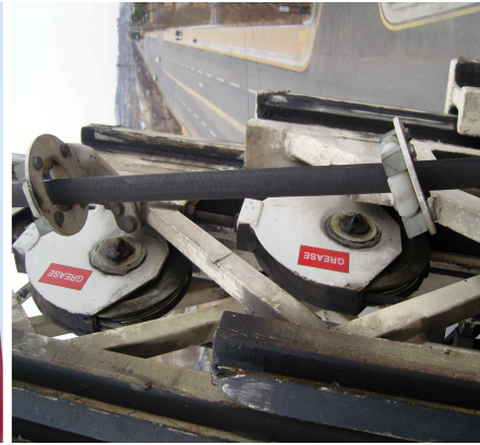
롤러의 그리스 주입 및 손상여부 확인
