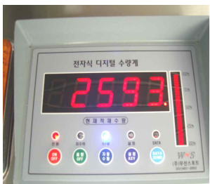
펌프 조작반 수량계
