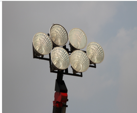
조명등 점등, 파손 여부 확인
