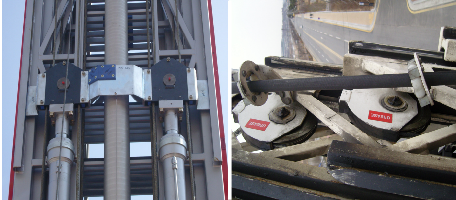
신장실린더 오일 누유 및 신장 롤러 확인 롤러의 그리스 주입 및 손상여부 확인
