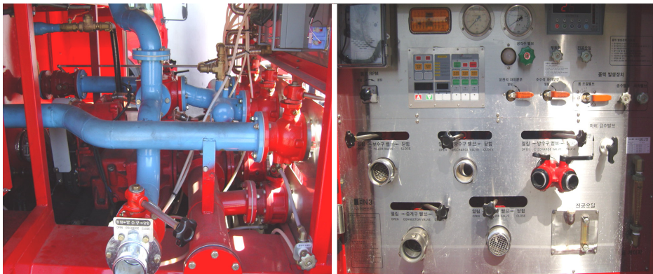
펌프 성능 시험 상태에서 각 배관 및 방수구의 누수, 심한 진동, 밸브의 개폐 여부 등을 확인한다.
