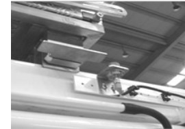
승강기 하강 정지 센서
