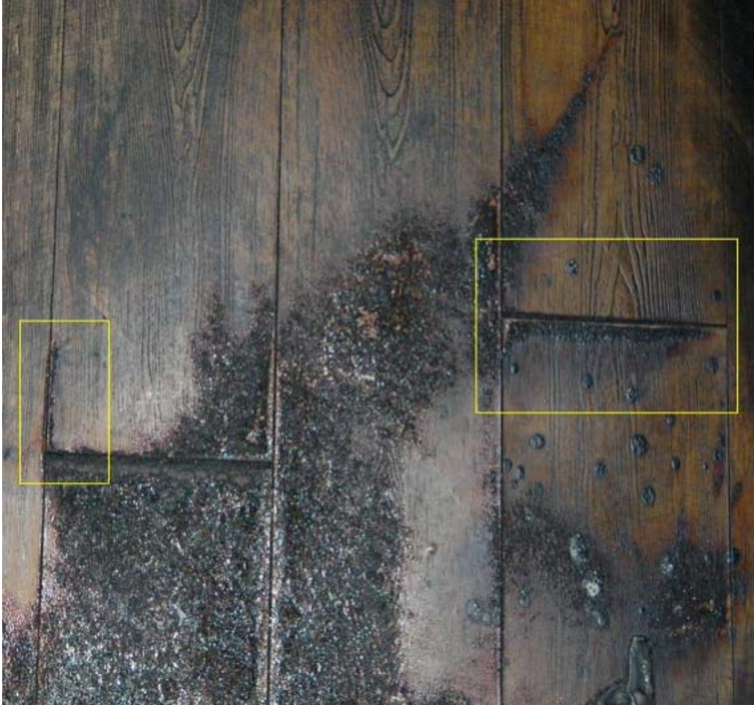
〈사진45〉 유류에 의한 틈새의 연소 패턴 28)
