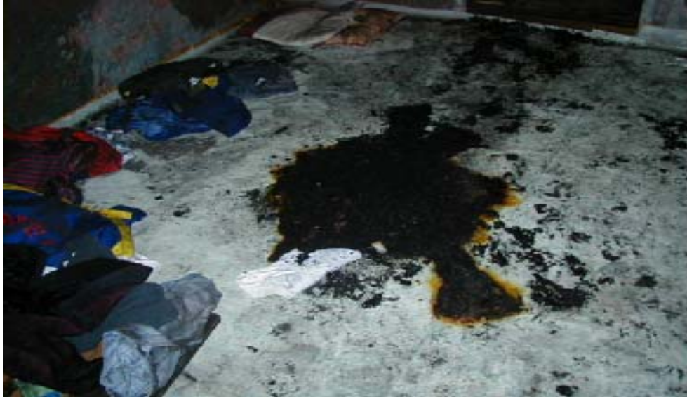
〈사진41〉 연소촉진제의 살포에 의한 바닥의 소손상황 24)
