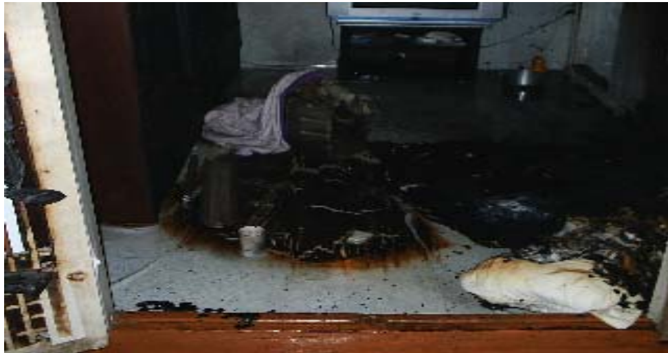
〈사진42〉 연소촉진제의 살포에 의한 바닥의 소손상황
