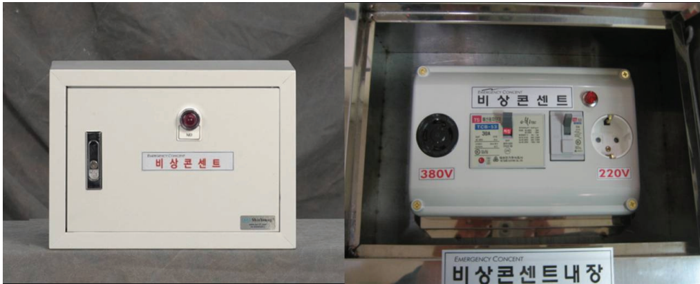
(그림 3) 비상콘센트설비함 및 소화전함 내장형
