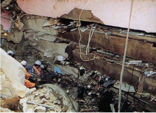
[그림 5-88] 전형적인 팬케이크형 붕괴(삼풍 백화점 붕괴사고 95. 6. 29)
